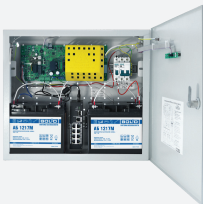
Рисунок 71. РИП-48 исп.01 с установленным внутри коммутатором SW-108
