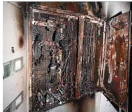
Рис. 1. Электрический шкаф после пожара
