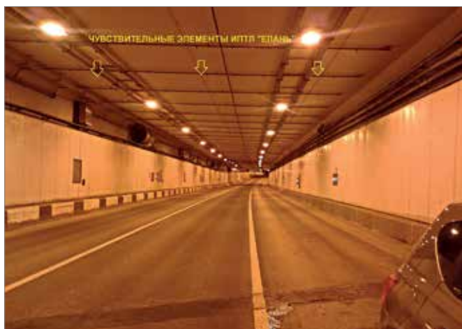
Фото 2. Москва. Алабяно-Балтийский автомобильный тоннель. Подвес оптоволоконного чувствительного элемента (ЧЭ) над дорогой
