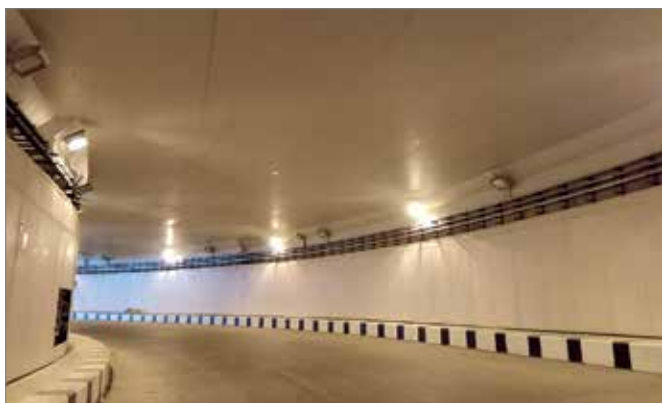
Фото 6. Московская область. Калужский разворотный тоннель. Три линии ЧЭ ИПТЛ «ЕЛАНЬ». Сколько бы здесь потребовалось точечных тепловых извещателей?
